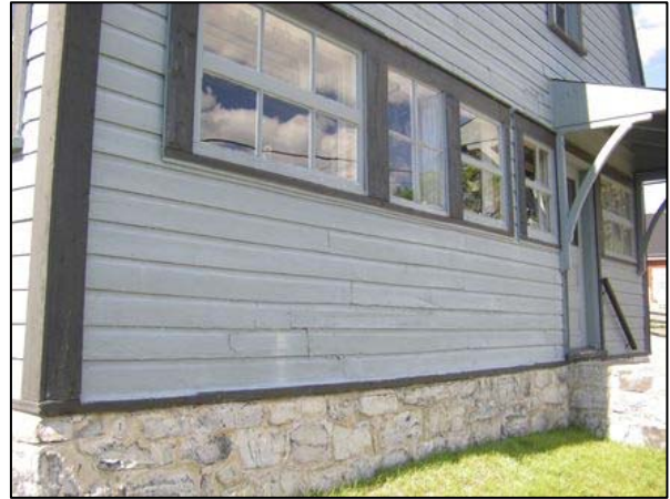
Bâtiment agricole recouvert de planches à feuillures, localisé au 290, rue Principale, Saint-Irénée.
